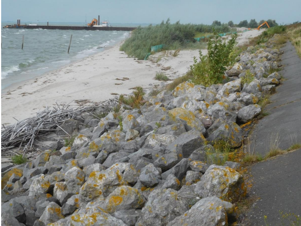
Figuur 2.10 Pilot Houtribdijk vanuit het zuiden. De afgeslagen oever en het ondermijnde struweel op de (sterk overstoven) leeflaag zijn goed zichtbaar evenals de restanten van een wilgentakken dam in het 'vloedmerk' (foto: Rienk-Jan Bijlsma, september 2017).
